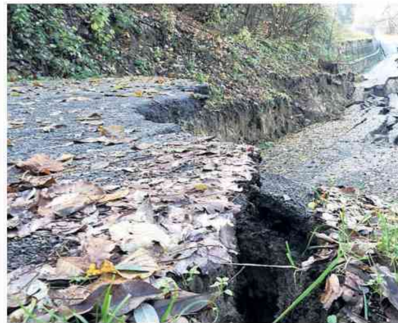
Una delle frane causate dal maltempo in autunno nell'Acquese
