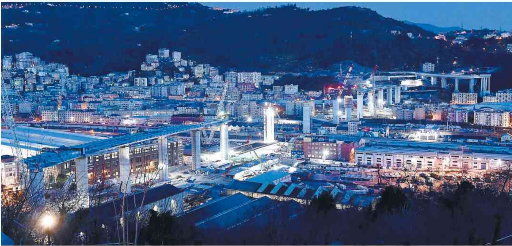
Un'immagine dei lavori in corso, ieri, sul viadotto che sostituirà il ponte Morandi, crollato il 14 agosto 2018
