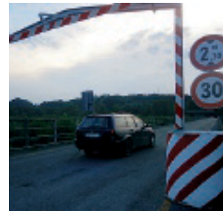
DIVIETI Il ponte 'in attesa'
