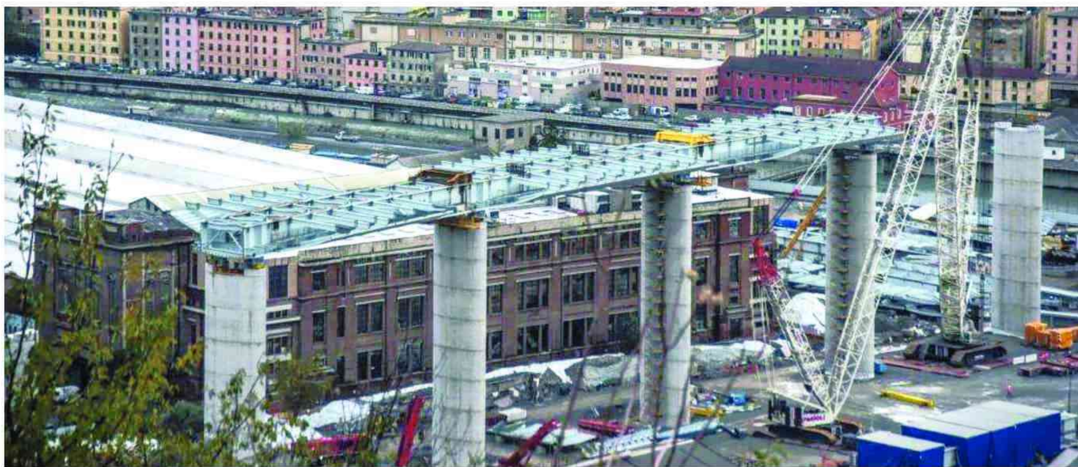
Il ponte progettato da Renzo Piano in costruzione a Genova sul torrente Polcevera dopo il crollo del Ponte Morandi che ha causato la morte di 43 persone
