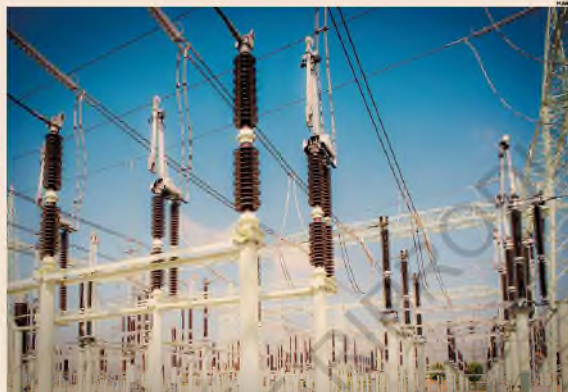
Produzione energetica. La centrale termoelettrica AZA di Cassino D'Adda
