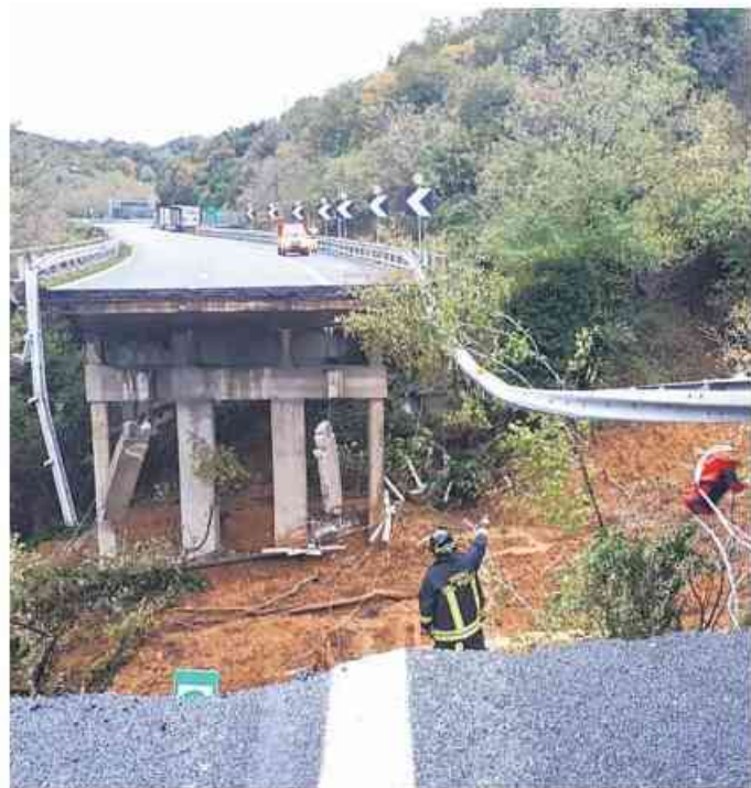
Il tratto del viadotto crollato sulla A6
