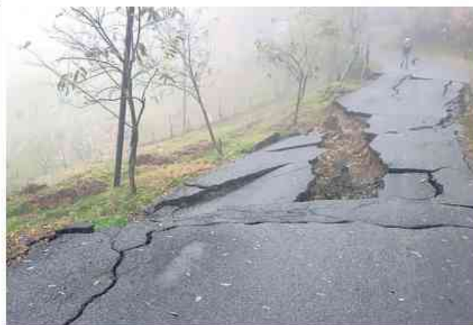
Una delle frane a causa delle quali Bandita di Cassinelle è isolata
