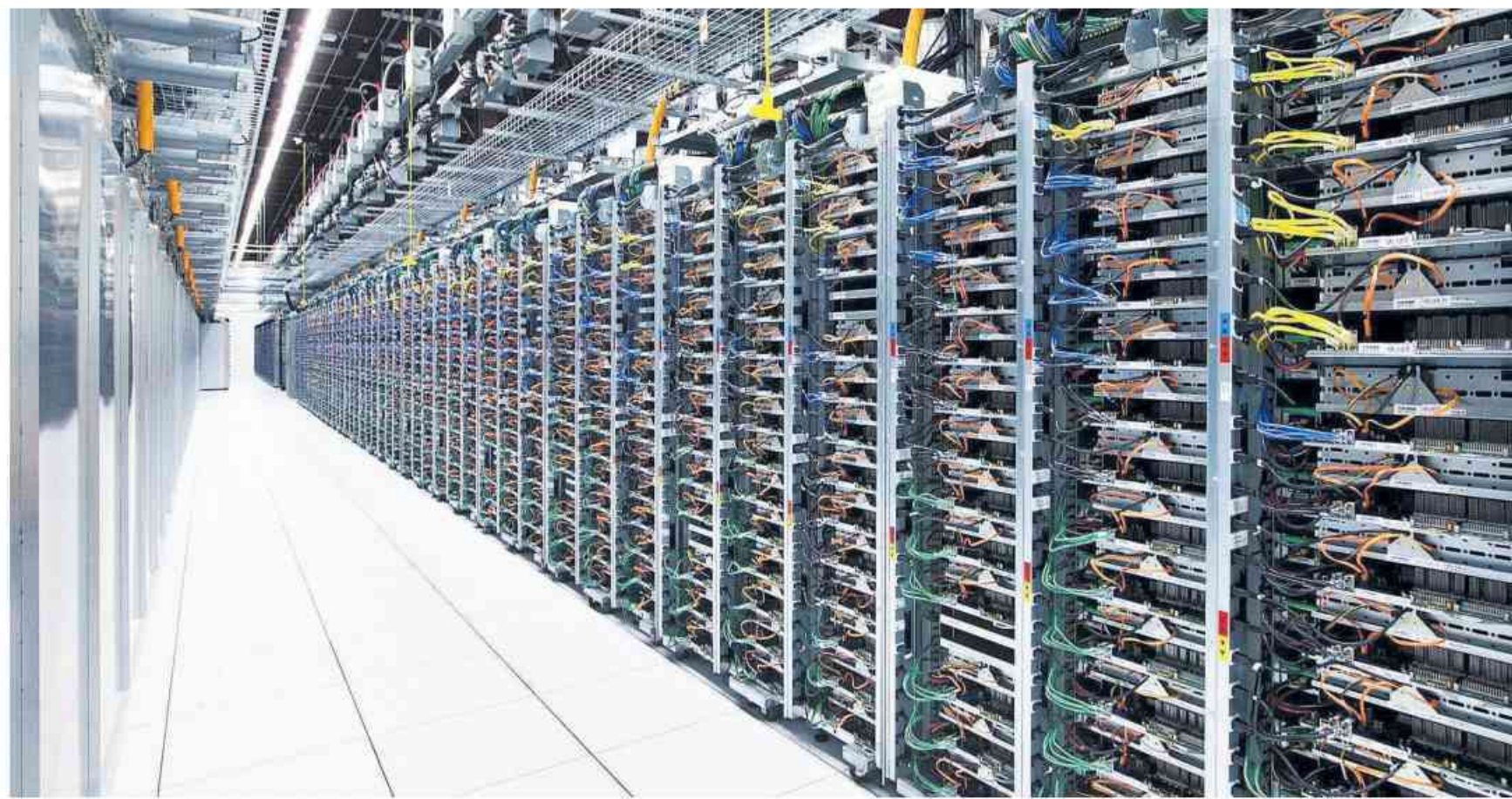
L'interno di un data center di Google: quello che nascerà a Torino è il primo frutto dell'alleanza tra il colosso di Mountain View e Tim
