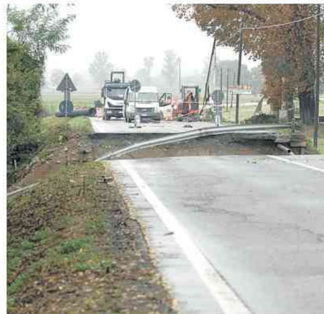
Il ponte crollato durante l'alluvione nelle vicinanze di Capriata
