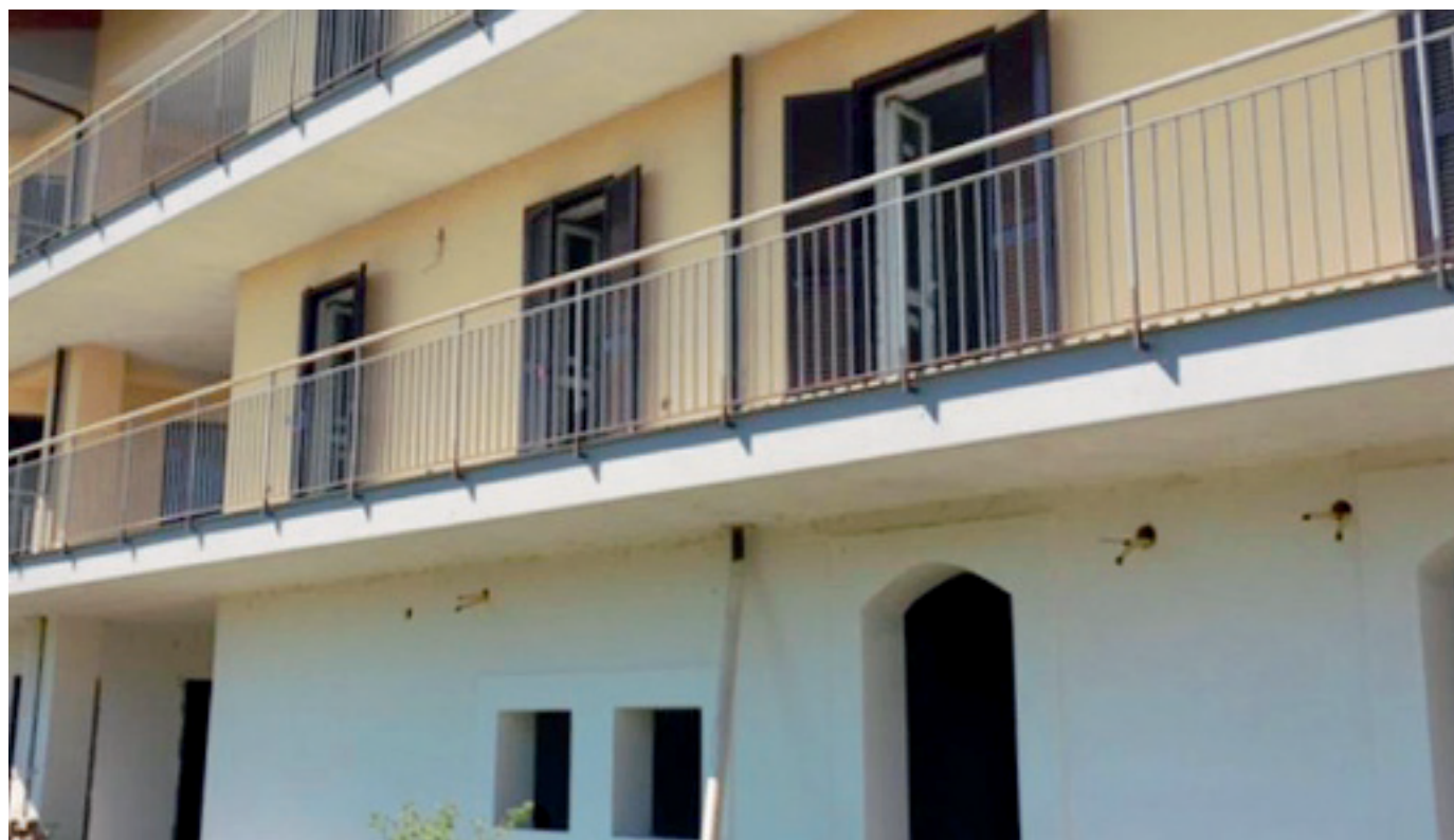
SAN MICHELE La struttura dovrebbe essere destinata a persone in difficoltà. Il progetto ha più di 10 anni e non è ancora concluso
