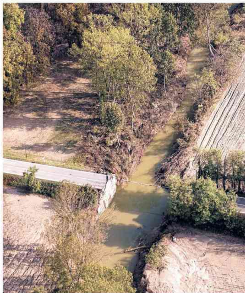
Il ponte crollato sulla Novi Ligure-Ovada, con ripercussioni sulla viabilità provinciale; a fianco, un lavoratore rientra alla ArcelorMittal di Novi per recuperare materiale
